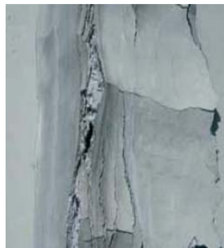
Muro in C.A. di un allevamento di animali
