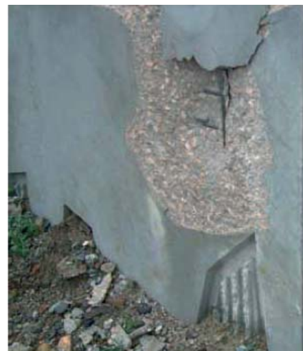
Muro in C.A. soggetto a gelo/disgelo
