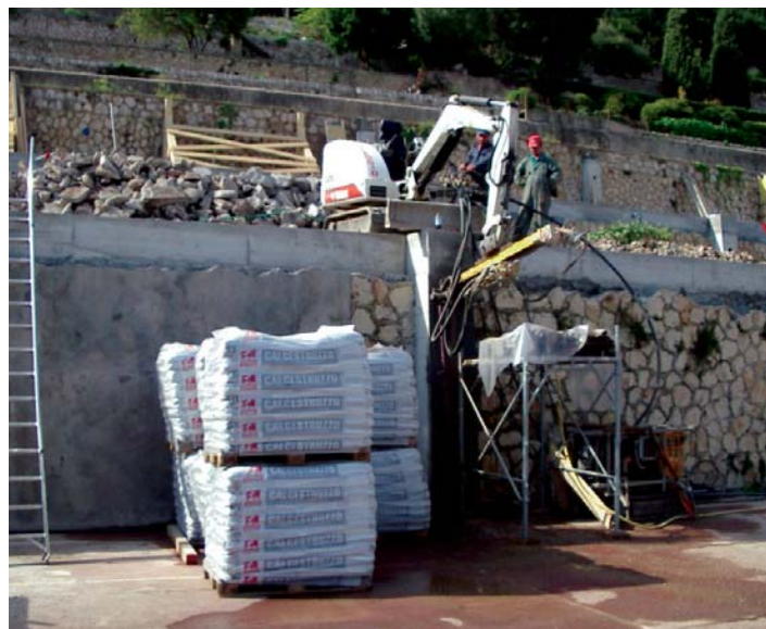
Terrazzamenti realizzati con muri di contenimento e contrafforti in CALCESTRUZZO FIBRATO strutturale
