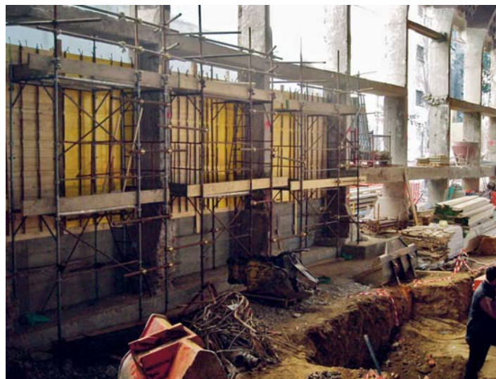
Muri di contenimento contro terra realizzati con CALCESTRUZZO FIBRATO strutturale nella ristrutturazione di uno spazio commerciale a Milano.
