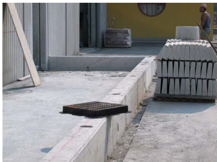
Realizzazione di muro di recinzione con BETONRAPID. La rapidità di indurimento permette un utilizzo quasi immediato del manufatto.
