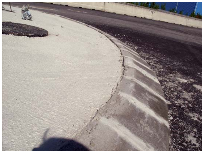
Lavori stradali realizzati con BETONRAPID (rotonde e inghisaggio chiusini) in cui è determinante la rapidità di asciugatura del prodotto.
