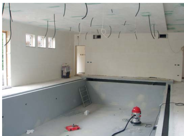
Rasatura di pareti in locale con destinazione d'uso a piscina. RASATUTTO BASE GESSO è infatti indicato anche in ambienti umidi.
