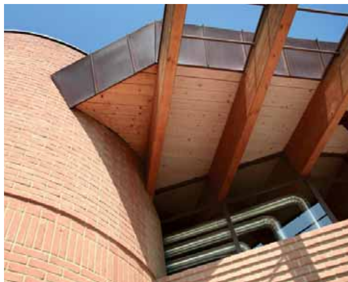
Particolare di una facciata realizzata con mattoni faccia a vista allettati con MALTA A VISTA OCRA (La Morra-CN)
