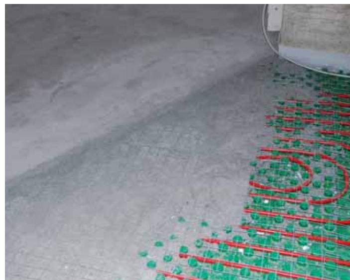
Posa di SUPER SABBIA E CEMENTO FIBRORINFORZATO per la realizzazione di pavimento riscaldato con pannelli radianti.
