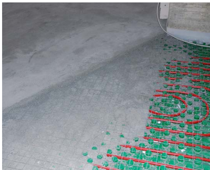
Application de SUPER SABBIA E CEMENTO FIBRORINFORZATO pour la réalisation de sol chauffant avec panneaux radiants.
