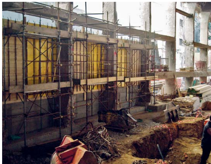
Stützmauern für Keller aus strukturellem CALCESTRUZZO FIBRATO bei der Sanierung einer Gewerbefläche in Mailand.
