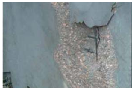
Muro in C.A. soggetto a gelo/disgelo
