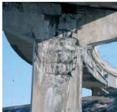
Pilastro in C.A. esposto alla pioggia
