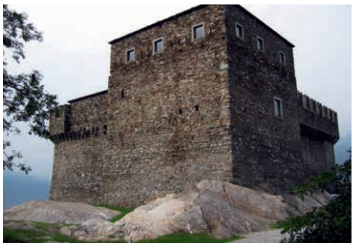
Stilatura con MALTA ANTICA SILIGRAS dei blocchi in pietra delle mura del Castello di Sassocorbaro a Bellinzona.
